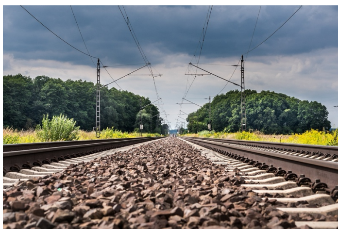
Abbildung 12: Beispiel einer Bahnstromanlage (Quelle: Pixabay)
